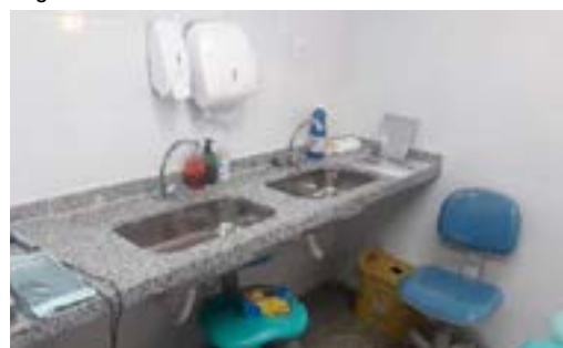
Pias de lavagem de mãos e pia de lavagem de instrumentais sem distância mínima de separação e sem barreira física entre elas
