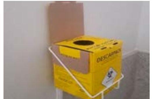
Suporte adequado para caixa coletora de resíduos perfurocortante
